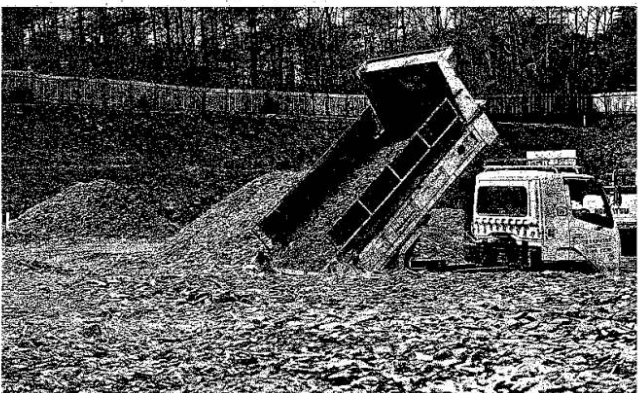
産業廃棄物の最終処分場に運び込まれるがれき（3月、栃木県内）
